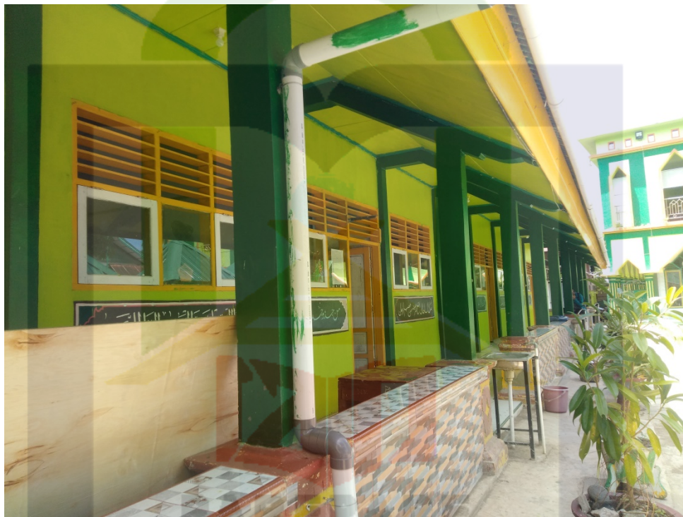
Kondisi Bangunan Kelas Madrasah Tsanawiyah DDI Takkalasi
