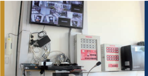
— Ruang Server yang Modern —
